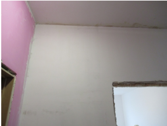
Фото №7 Общий вид на отделку коридора кв. № 17. На потолке и стенах видны следы от шпаклевки.
