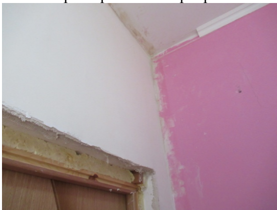
Фото №11 Общий вид на отделку коридора кв. № 17. На потолке и стенах видны следы от шпаклевки.
