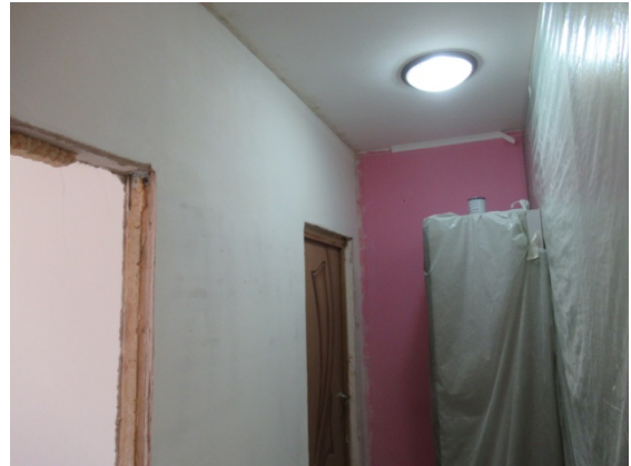
Фото №8 Общий вид на отделку коридора кв. № 17. На потолке и стенах видны следы от шпаклевки.
