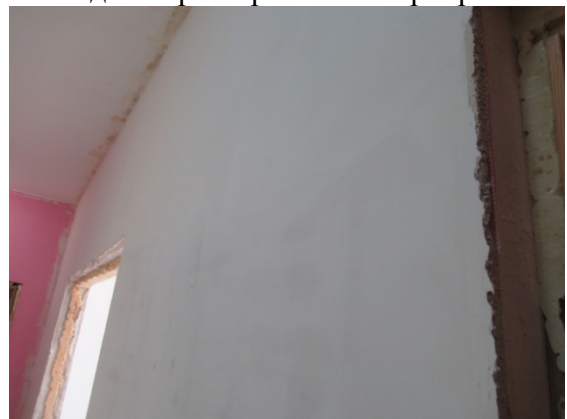
Фото №12 Общий вид на отделку коридора кв. № 17. На потолке и стенах видны следы от шпаклевки.
