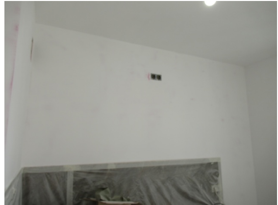
Фото №10 Общий вид стены в помещении кухни кв. 17. На стене видны следы старой краски и непрокрасы.
