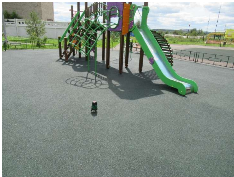
Фото № 10. Состояние универсального покрытия на основе резиновой крошки на детской площадке с детским игровым комплексом. Выполнение контрольных измерений лазерным построителем плоскости.
