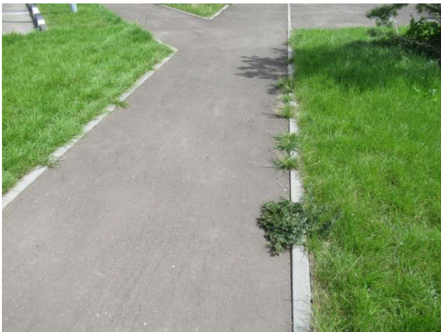
Фото № 33. Между асфальтобетонным покрытием и бортовыми камнями видна проросшая трава.
