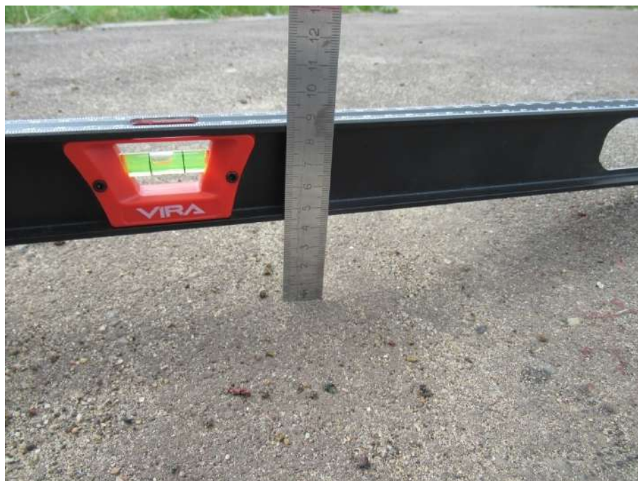
Фото № 18. Контрольный замер величины просвета между контрольной рейкой и асфальтобетонным покрытием, в местах просадки оснований. Отклонение от ровности асфальтобетонного покрытия составляет 45 мм.
