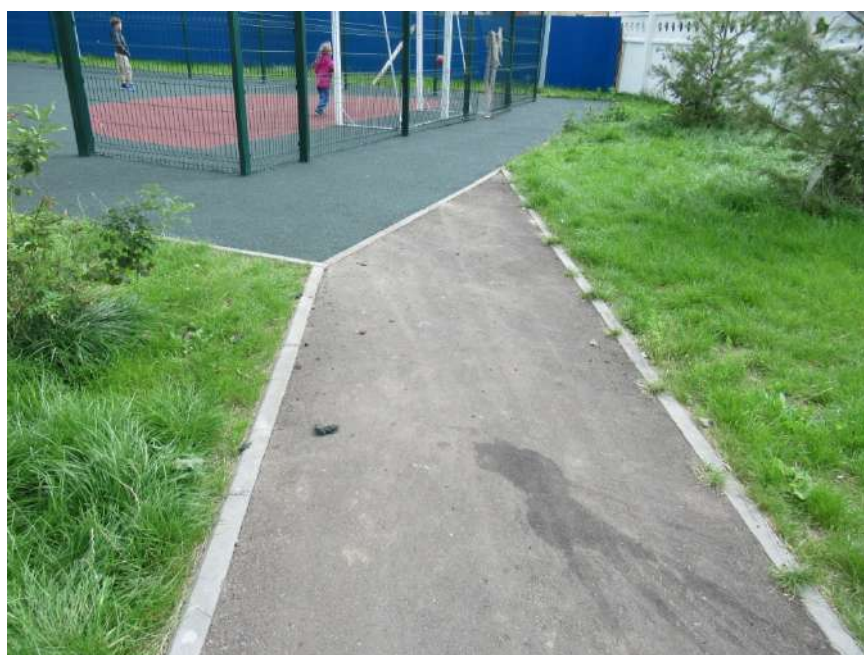
Фото № 36. Между асфальтобетонным покрытием и бортовыми камнями видна проросшая трава.
