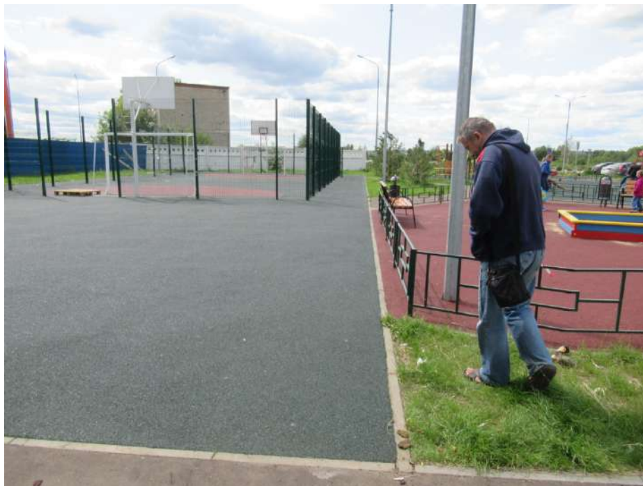
Фото № 9. Состояние универсального покрытия на основе резиновой крошки на спортивной площадке и детской площадке с песочницей.
