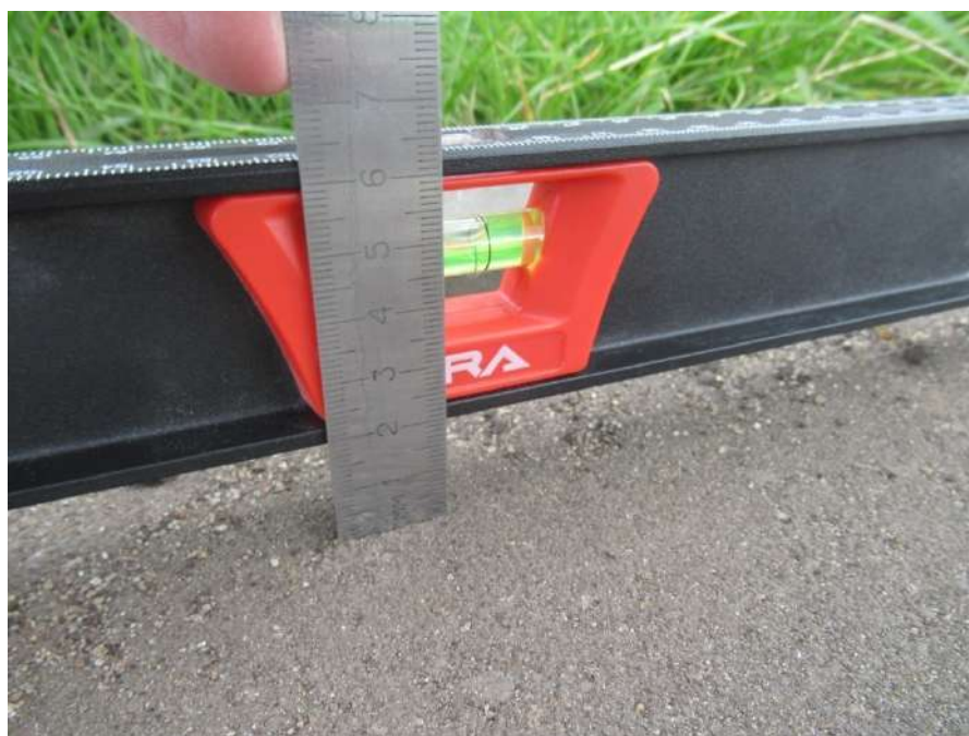
Фото № 30. Контрольный замер величины просвета между контрольной рейкой и асфальтобетонным покрытием, в местах просадки оснований. Отклонение от ровности асфальтобетонного покрытия составляет 20 мм.
