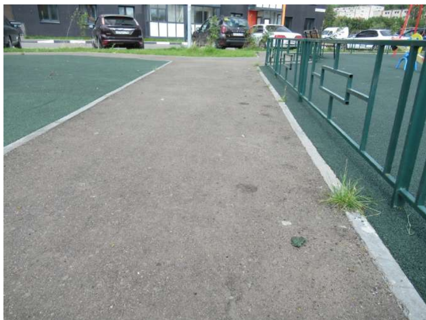
Фото № 35. Между асфальтобетонным покрытием и бортовыми камнями видна проросшая трава.
