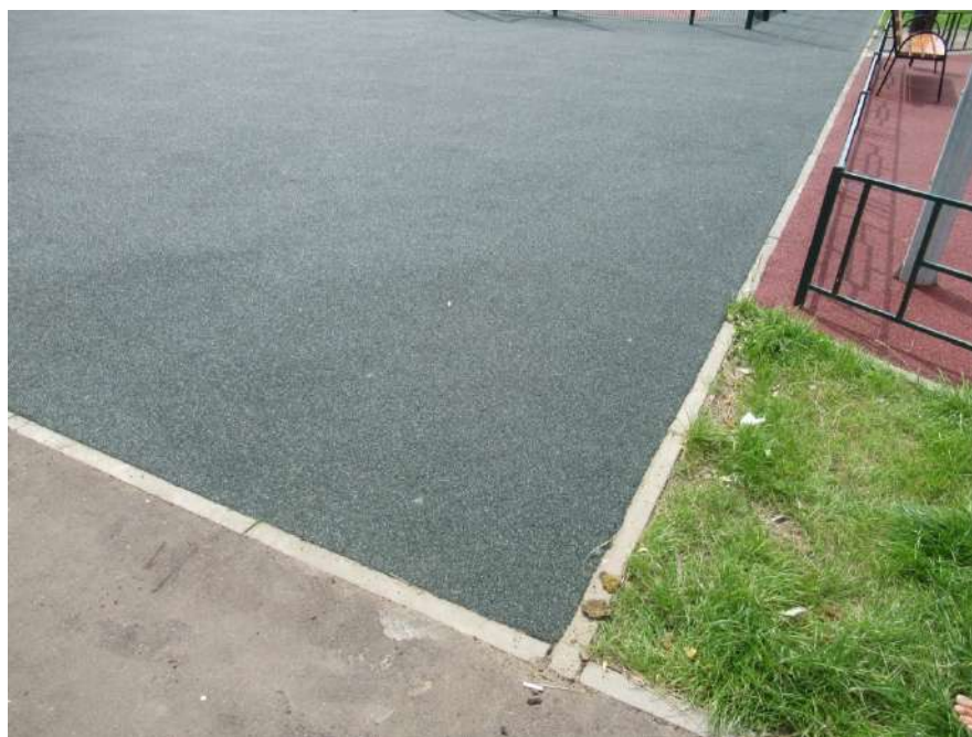
Фото № 42. На ботовом камне между спортивной площадкой и газоном видны остатки резинового покрытия темно-желтого оттенка, предположительно демонтированного.
