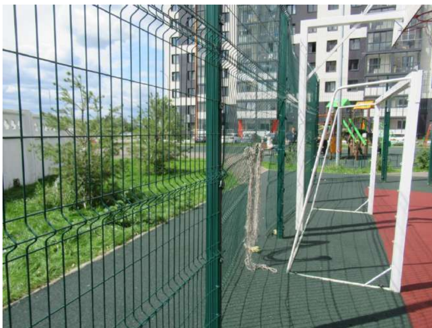
Фото № 15. Состояние ограждений спортивной площадки. Металлические элементы ограждения имеют повреждения, часть секций ограждения не закреплено надлежащим образом.
