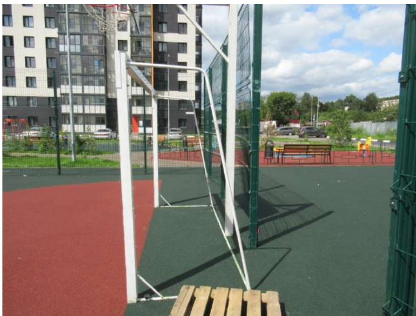
Фото № 16. Состояние ограждений спортивной площадки. Металлические элементы ограждения имеют повреждения, часть секций ограждения не закреплено надлежащим образом. На поверхности универсального покрытия спортивной площадки присутствуют посторонние предметы.
