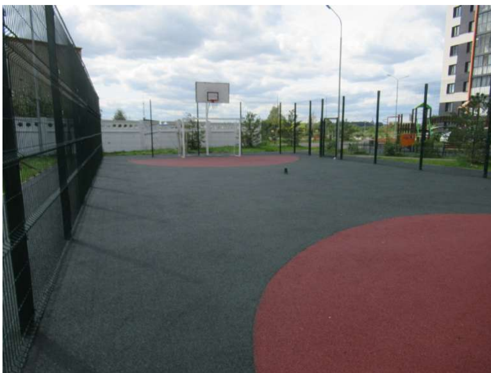
Фото № 8. Состояние универсального покрытия на основе резиновой крошки на спортивной площадке.
