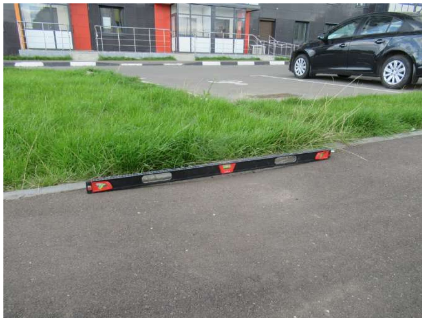
Фото № 29. Отвод воды с поверхности асфальтобетонных покрытий детских и спортивных площадок не организован. Асфальтобетонное покрытие в границах бортовых камней имеет провалы, приводящие к застою воды.
