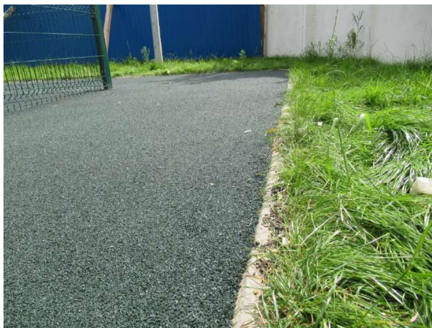
Фото № 39. Общий вид участка примыкания универсального покрытия к бортовым камням резинового на спортивной площадке.
