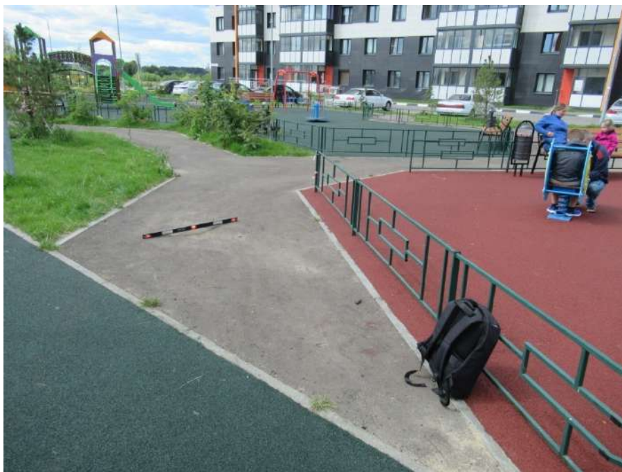
Фото № 17. Отвод воды с поверхности асфальтобетонных покрытий детских и спортивных площадок не организован. Асфальтобетонное покрытие в границах бортовых камней имеет провалы, приводящие к застою воды. В местах застоя воды виден песок. Между асфальтобетонным покрытием и бортовыми камнями видна проросшая трава.
