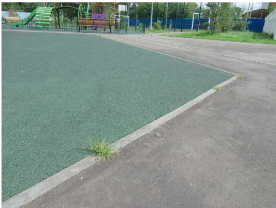
Фото № 34. Между асфальтобетонным покрытием и бортовыми камнями видна проросшая трава.
