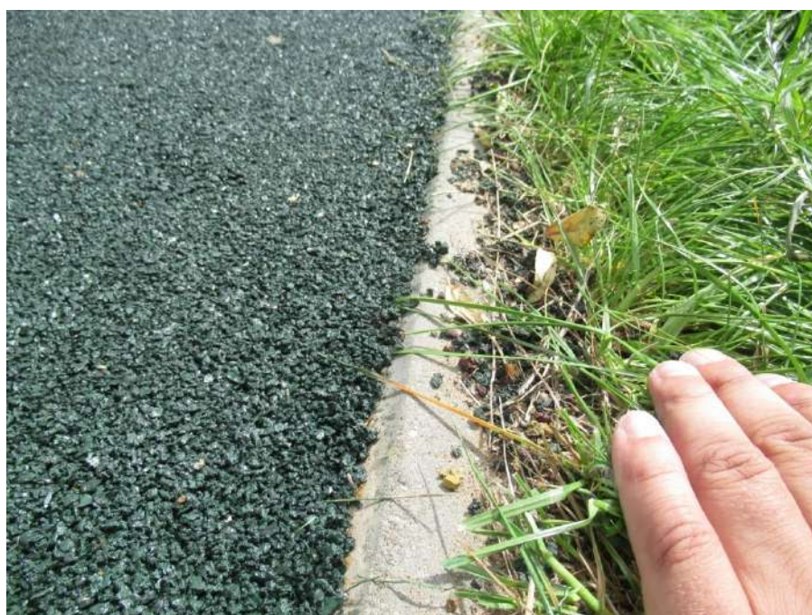
Фото № 40. Крупный план участка примыкания универсального покрытия к бортовым камням на спортивной площадке. Зеленые стебли травы проросшей на газоне прилипли полиуретановому связующему в зазоре между бортовым камнем и резиновым покрытием.
