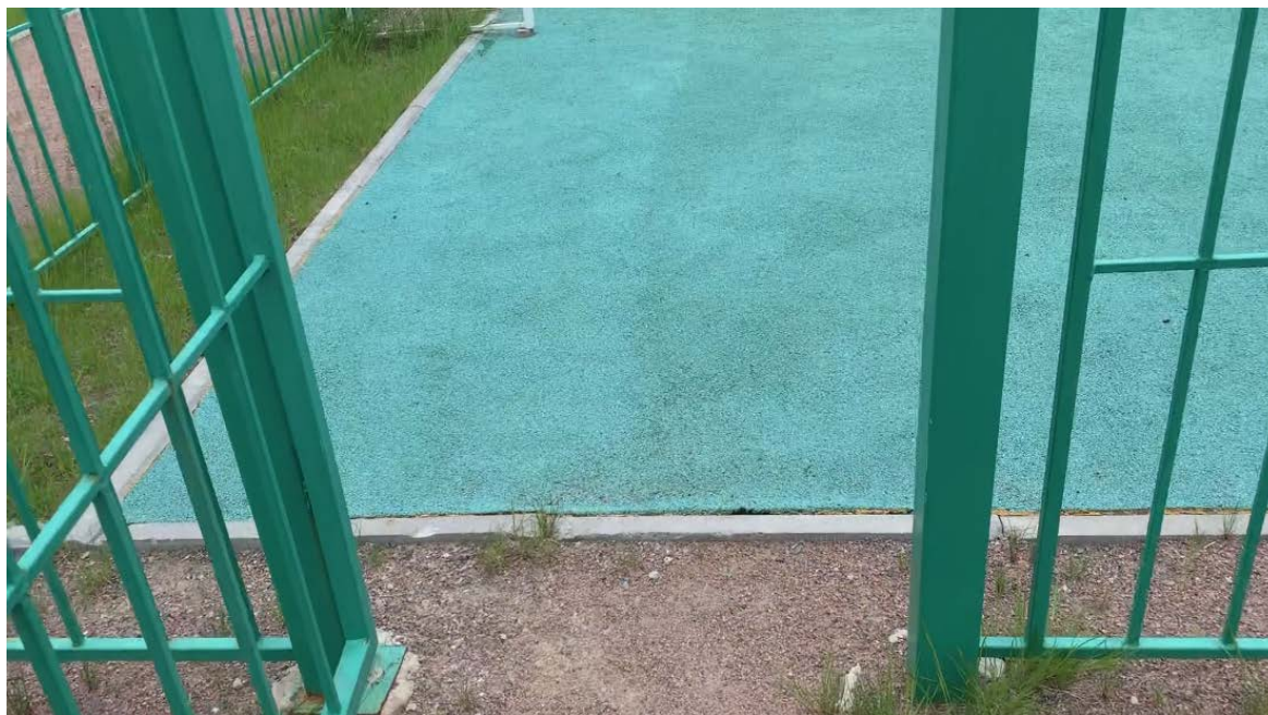
Фото № 9. Участки примыкания универсального покрытия на основе резиновой крошки к бортовым камням на площадке №1 при входе. На примыканиях универсального покрытия к бортовым камням видны зазоры, заполненные монтажной пеной.
