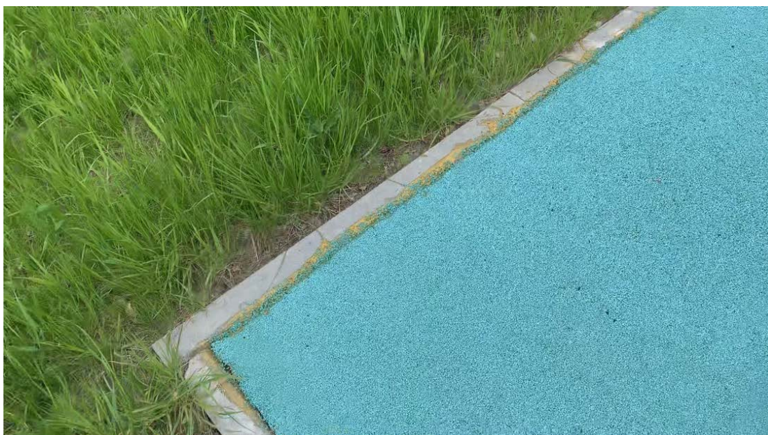
Фото № 13. Участка примыкания универсального покрытия к бортовым камням на площадке №2 вдоль ограждения. Зазоры между бортовым камнем и резиновым покрытием заполнены монтажной пеной, следы монтажной пены видны на поверхности бортовых камней.
