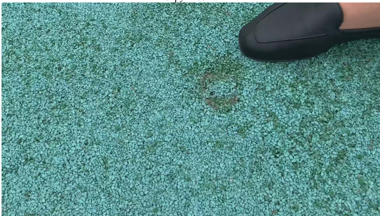
Фото № 28. Следы ремонта универсального покрытия клеящими составами на площадке №1 в центральной части покрытия. Клеящий состав на поврежденном участке №2 нанесен по окружности.
