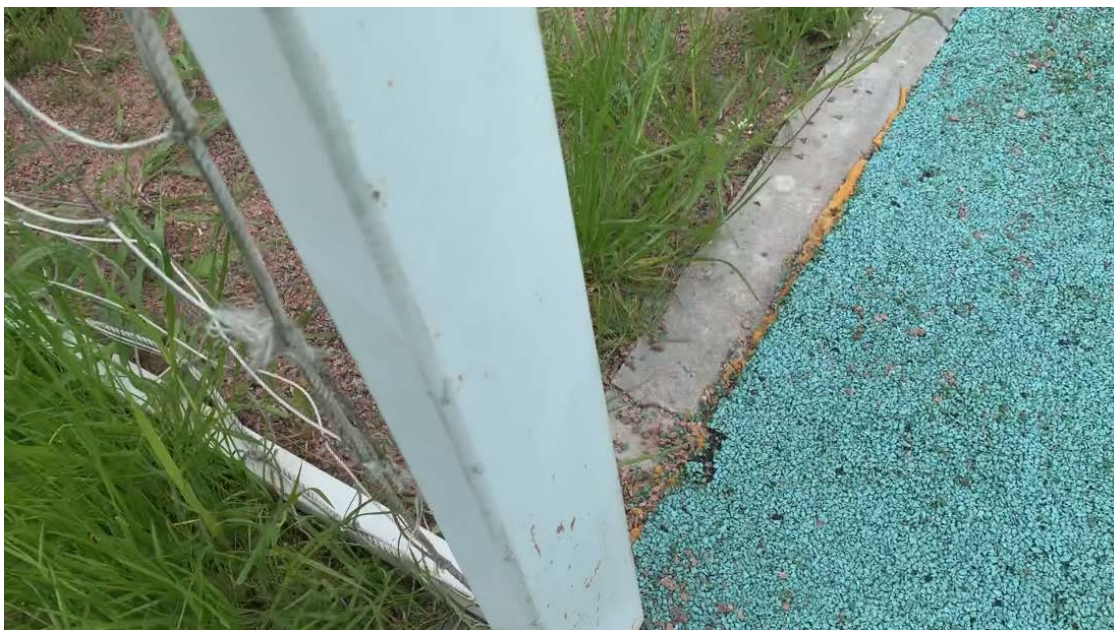
Фото № 5. Участок примыкания универсального покрытия к бортовым камням на площадке №1 в створе футбольных ворот. Между резиновым покрытием и бортовым камнем видна монтажная пена. Поверхность универсального покрытия засорена частицами гранитного отсева.
