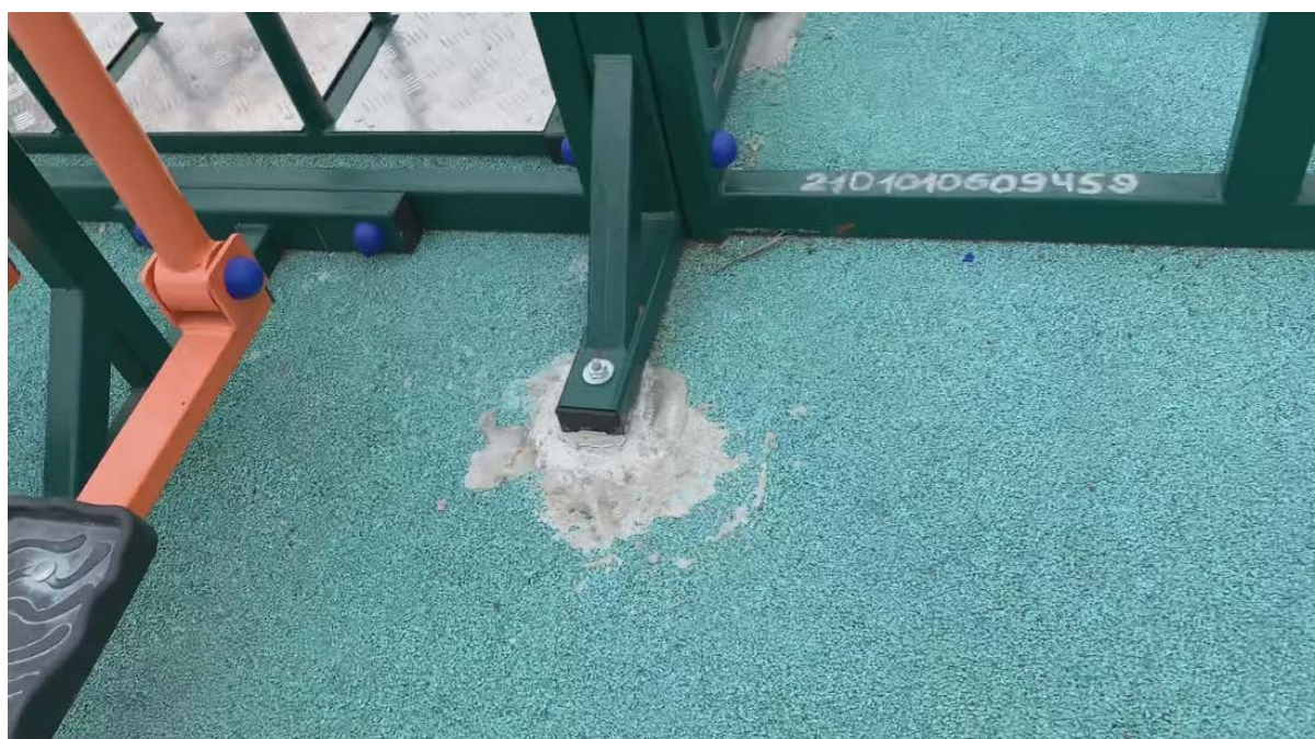
Фото № 24. Крепление опорной конструкция тренажерного комплекса к закладным деталям фундамента смонтированного на площадке №2 у тренажера степпер. Места примыкания универсального покрытия к блоку фундамента залиты цементным раствором поверх
