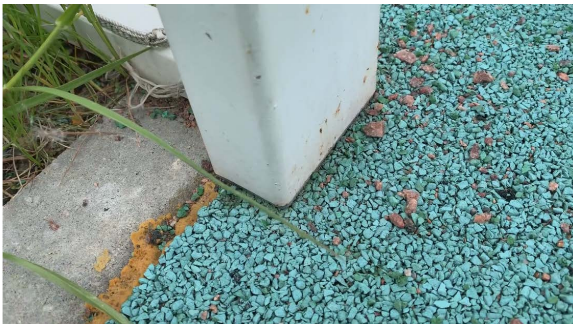
Фото № 6. Участок примыкания универсального покрытия к бортовым камням на площадке №1 у левой стойки футбольных ворот. Между резиновым покрытием и бортовым камнем видна монтажная пена. На поверхности универсального покрытия виден гранитный отсев.
