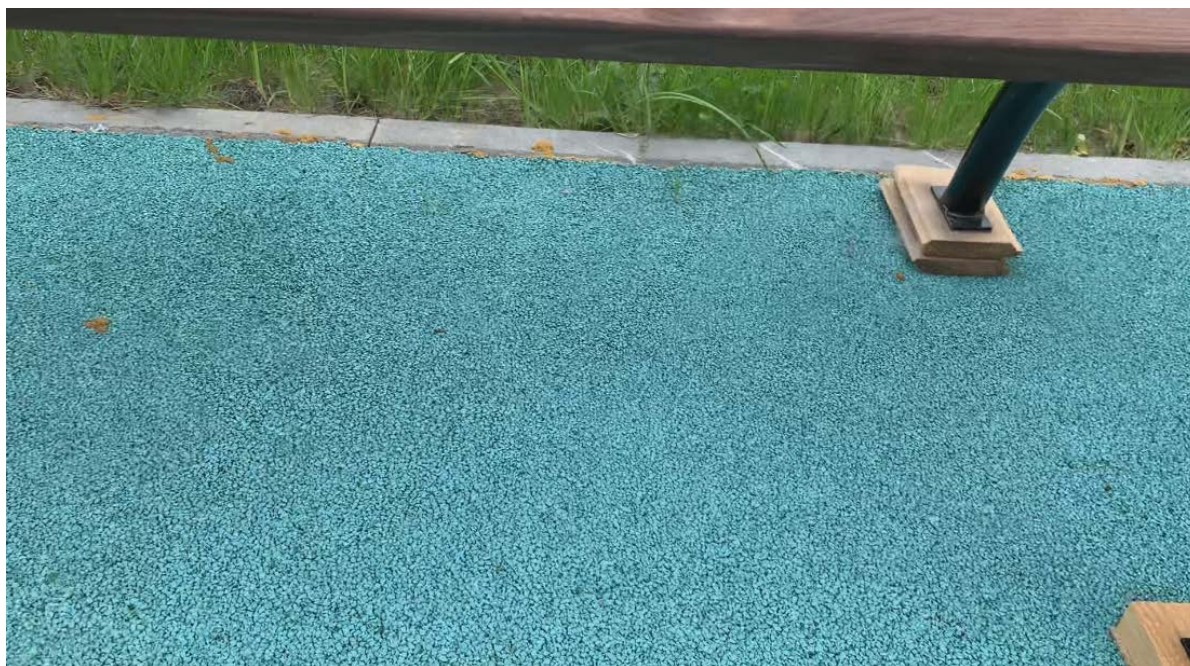
Фото № 16. Участок примыкания универсального покрытия к бортовым камням на площадке №2 у малых архитектурных форм. Зазоры между бортовым камнем и резиновым покрытием заполнены монтажной пеной, следы монтажной пены видны на поверхности бортовых камней и на поверхности универсального покрытия.
