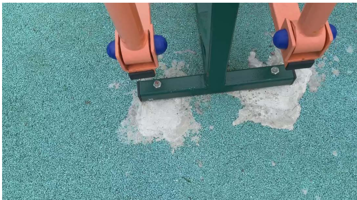
Фото № 23. Крепление опорной конструкция тренажерного комплекса к закладным деталям фундамента смонтированного на площадке №2 у тренажера лыжный ход. Места примыкания универсального покрытия к блоку фундамента залиты цементным раствором поверх универсального покрытия.
