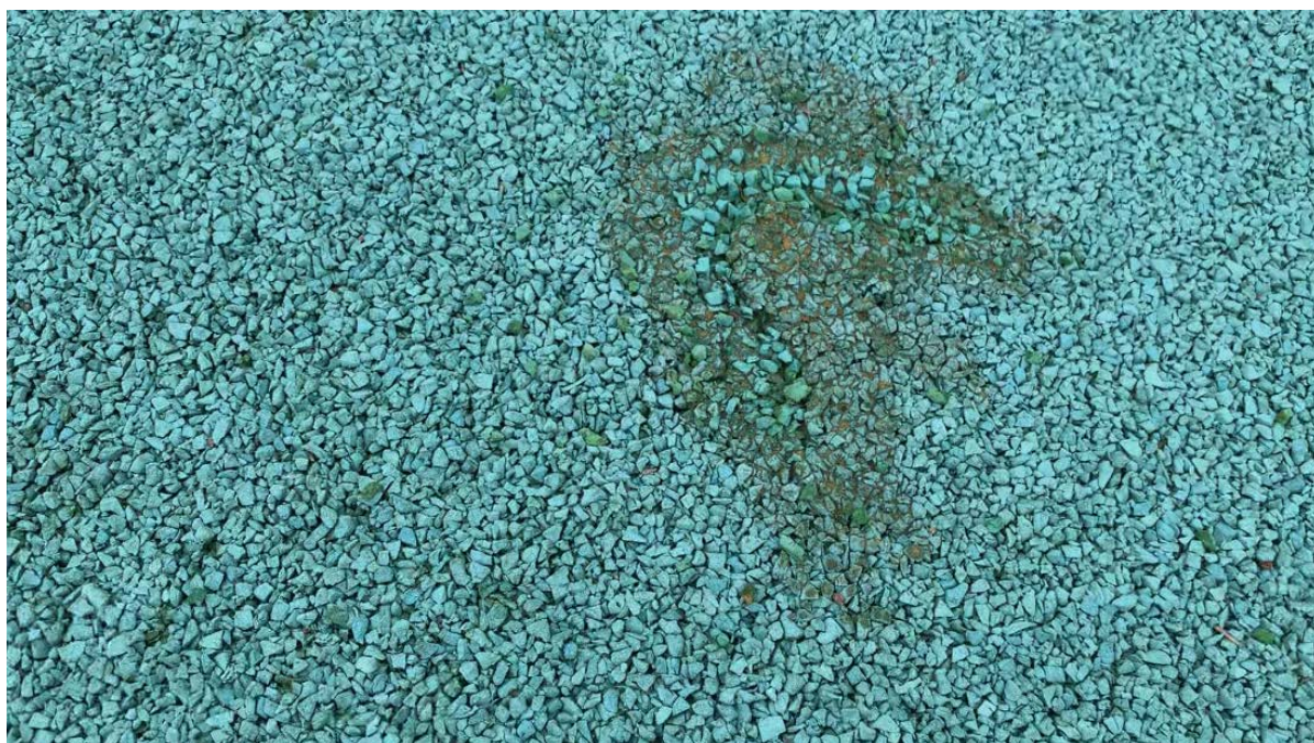
Фото № 29. Следы ремонта универсального покрытия клеящими составами на площадке №2 в центральной части покрытия. Клеящий состав на поврежденном участке №1 нанесен по дуге.
